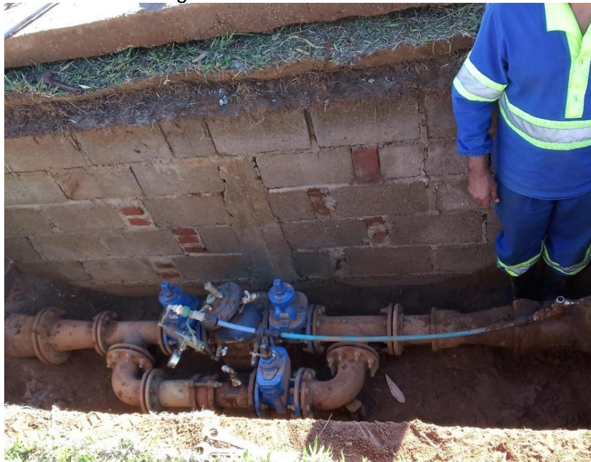
Imagem 8 - VRP existente no local
