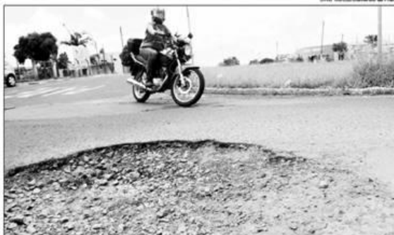
CRATERA - Motoqueiro passa diante de buraco na av. São Pedro, no Petrópolis, um dos bairros que serão atendidos pela operação
